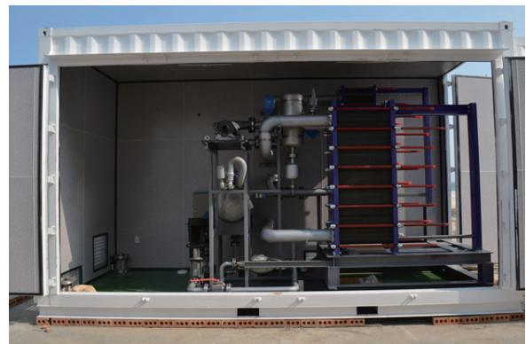
20kW 해수온도차발전 파일럿플랜트('13)
